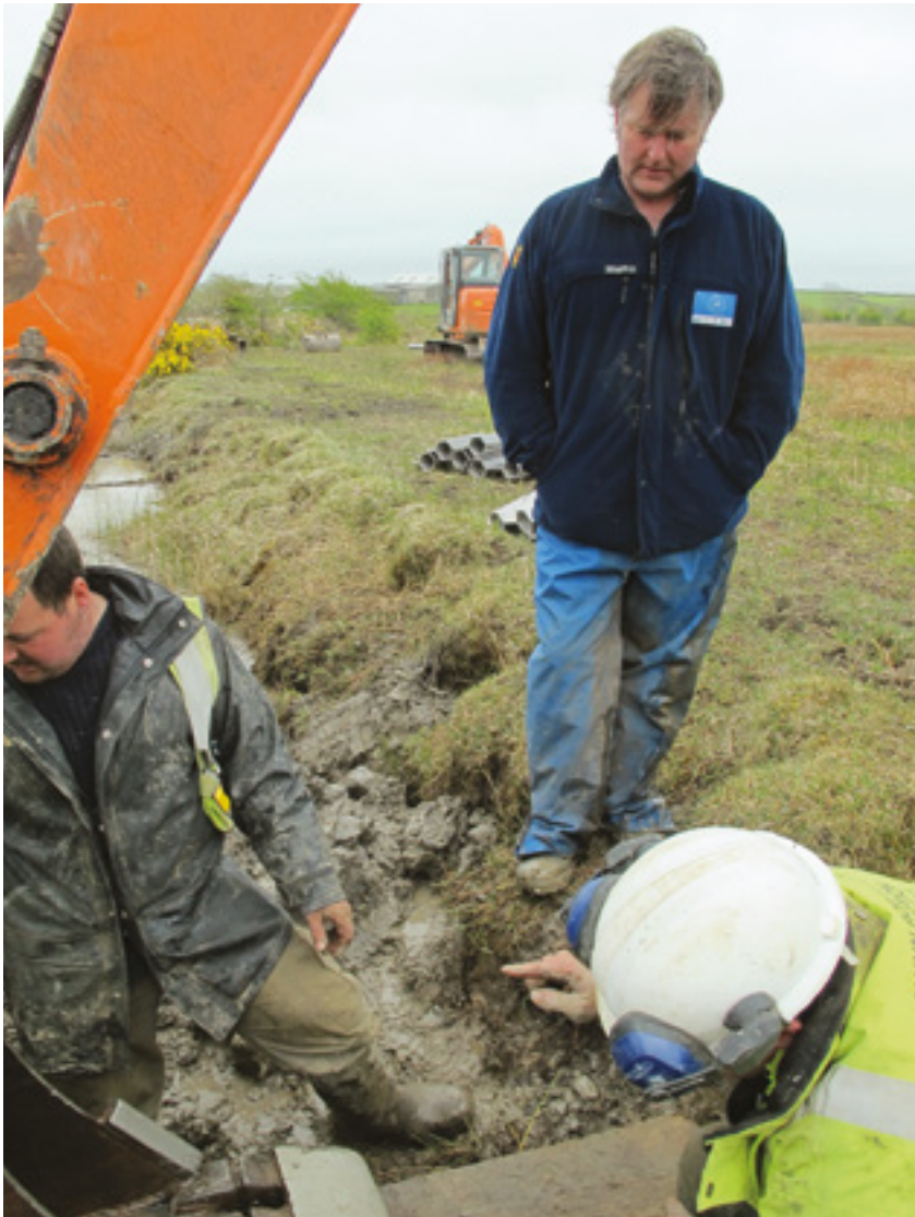
Cadwraethwyr a chontractwyr yn cydweithio gan ddefnyddio gwyddoniaeth i wneud yn siŵr fod dyfnder y dŵr yn gywir. Conservationists and contractors working together using science to ensure that the correct depth of water is achieved.
